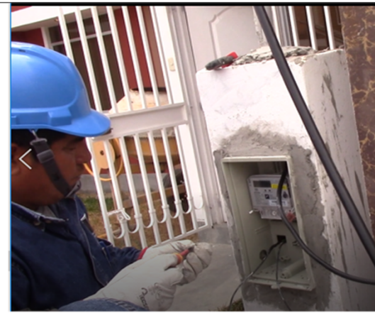
Fijación del medidor
