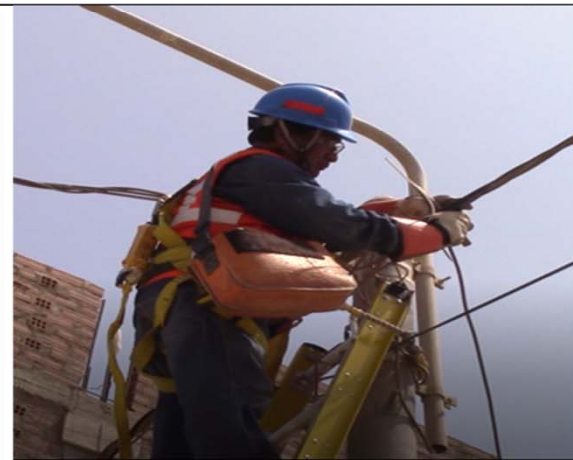
Empalme de acometida
