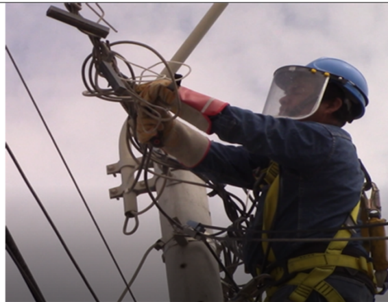
Empalme de acometida
