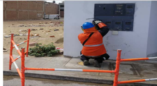
Fijación del medidor
